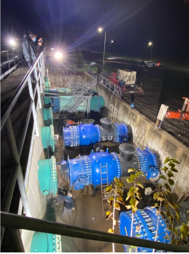
Depo Baęlantıları-1 Storage Connections-1
