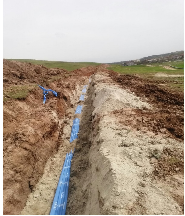
İçmesuyu Şebeke Hattı Water Transmission Line
