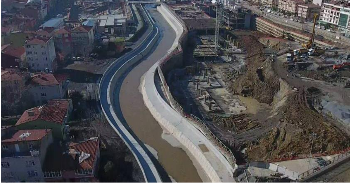
Hattın Genel Görünümü General View of the Project
