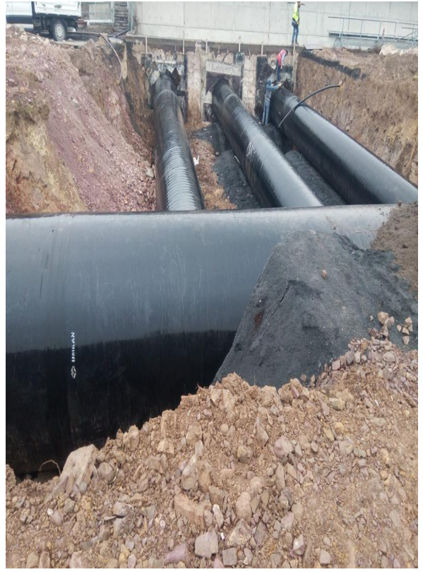
Depo Baęlantıları-2 Storage Connections-2
